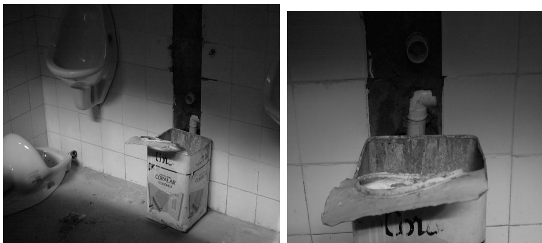
FIGURA 8: Destinação inadequada de embalagem de tinta, em reforma de uma Faculdade particular de Salvador - BA (2006) Fonte: fotografado por Valnêr Guimarães Junior
