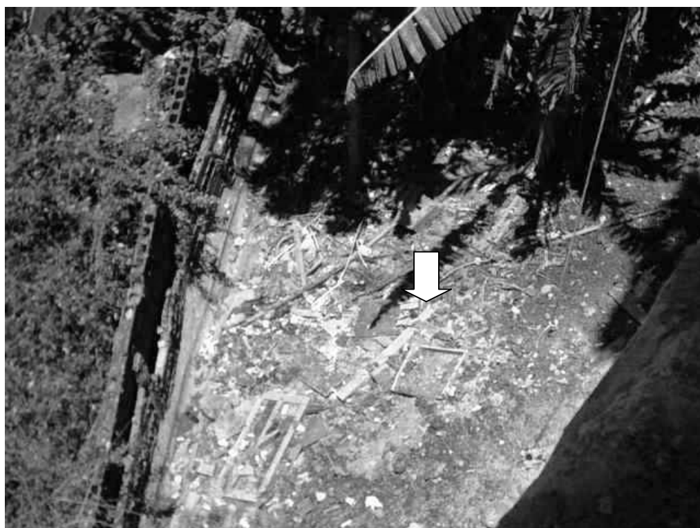
FIGURA 20: Acondicionamento inadequado de resíduos em canteiro de uma obra com implementação de gestão de resíduos. Salvador, BA.
