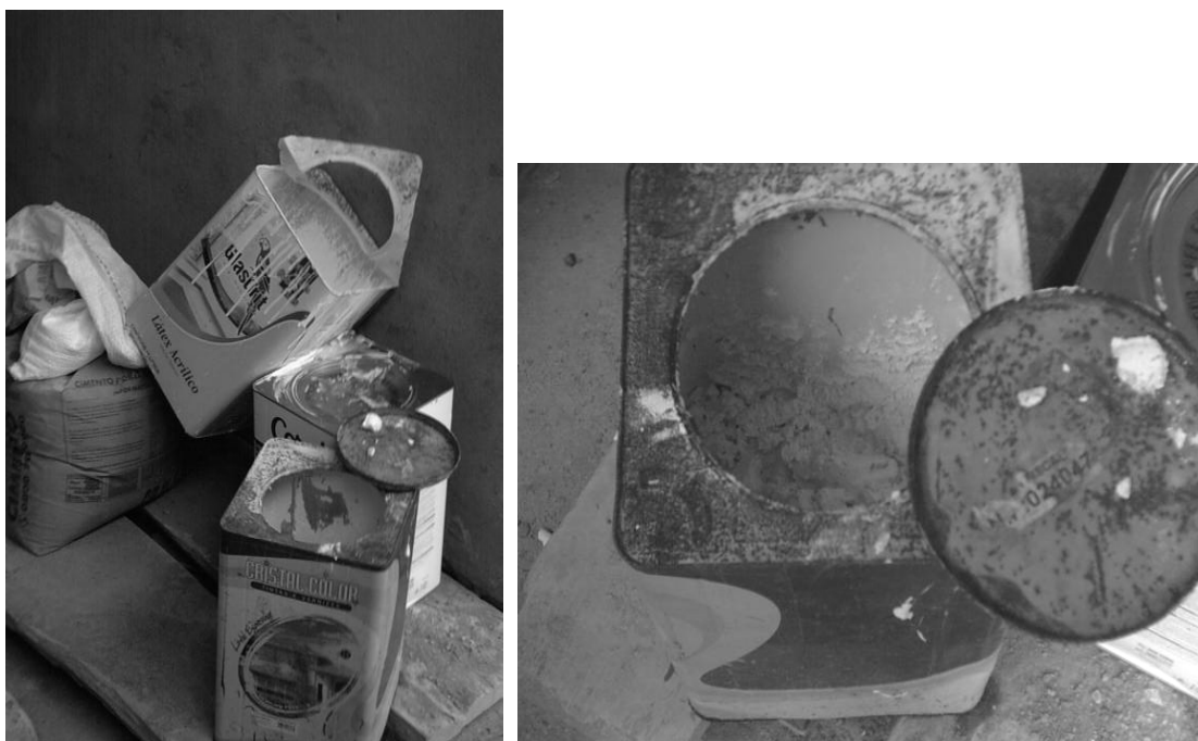
FIGURA 11: Armazenamento inadequado de embalagens de tintas com resíduos em canteiro de obras de um edifício de médio porte em Salvador – BA (novembro de 2006). Fonte: fotografado por Valnêr Guimarães Junior
