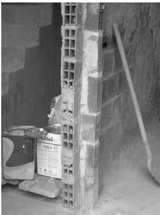
FIGURA 12: Armazenamento inadequado de embalagens de tintas com resíduos, em canteiro de obras de um edifício em Salvador-BA. (novembro de 2006).
