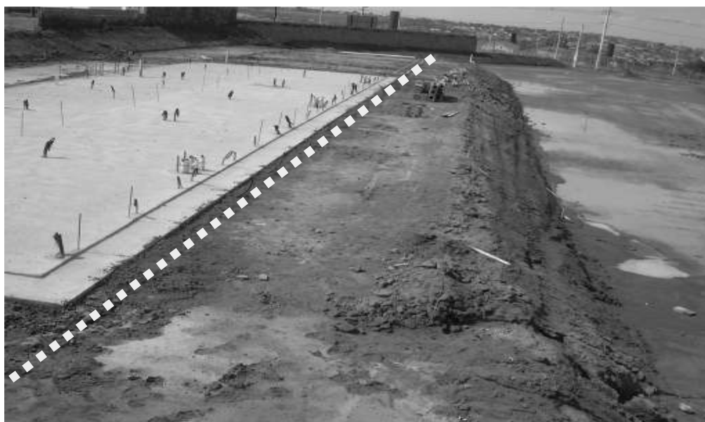
Figura 15. Detalhe de aterro e posicionamento do talude (a linha pontilhada indica a posição da crista do talude após o corte)
