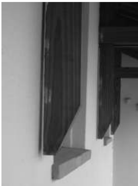
Figura 18. Detalhe do envergamento do telhado da varanda
