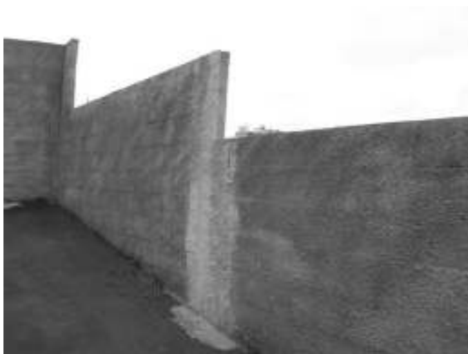
Figura 16. Detalhe de reforço em muro executado com blocos de 9 cm de espessura (necessidade de reforço estrutural)
