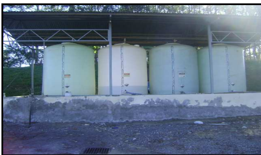
Figura 23 - Local de armazenamento do Hidróxido de Sódio
