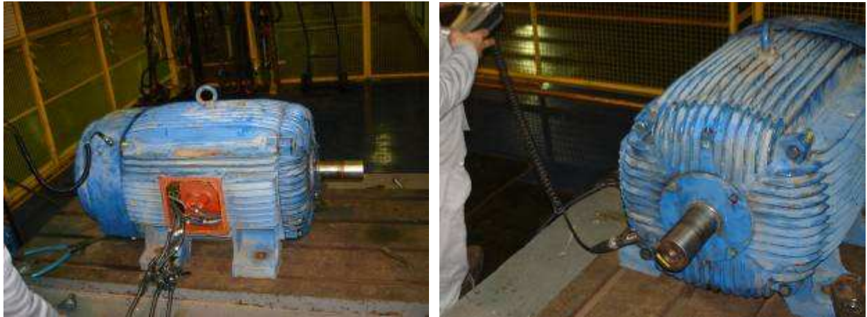
Figura 4.3 - Execução dos testes no Motor N°2
