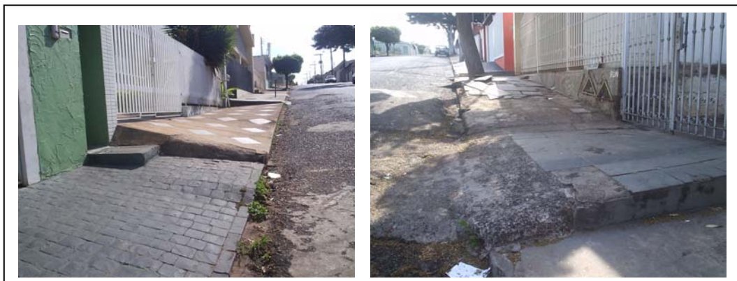
Figura 24 :Calçadas em desnível – Rua Niterói – Uberlândia - MG Autor: VILLELA, P. A., 2006
